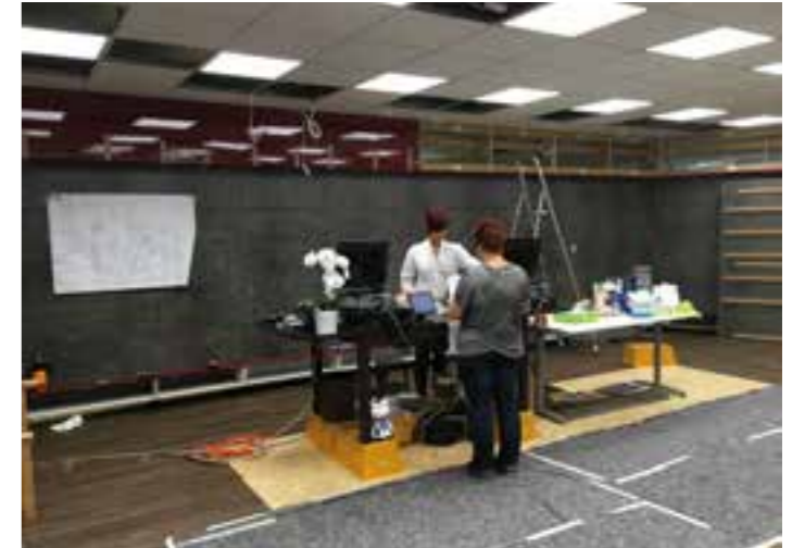
Die Mitarbeiter hatten in der Umbauphase viel zu verkraften, denn die Arbeiten fanden während des laufenden Betriebs statt
